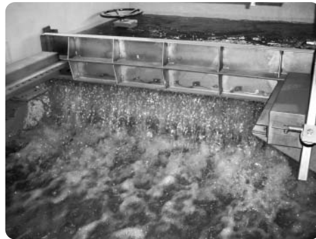
Danach erfolgt der Spülstoß.
