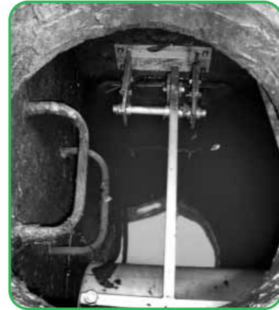
Anlage in Betrieb
