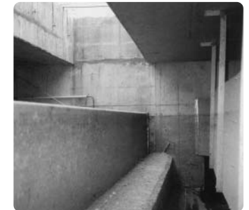
Ein Stauschild für konstante Wasserspiegellagen in Regenbecken und Kläranlagen.
